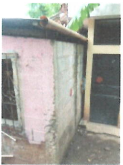
FOTO 3.: CANALES Y BAJADAS DE AGUA PLUVIAL. Sustitución de canal en mal estado
